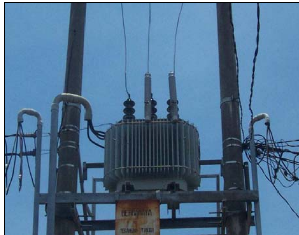
Gambar 2. Trafo Distribusi 200 kVA
